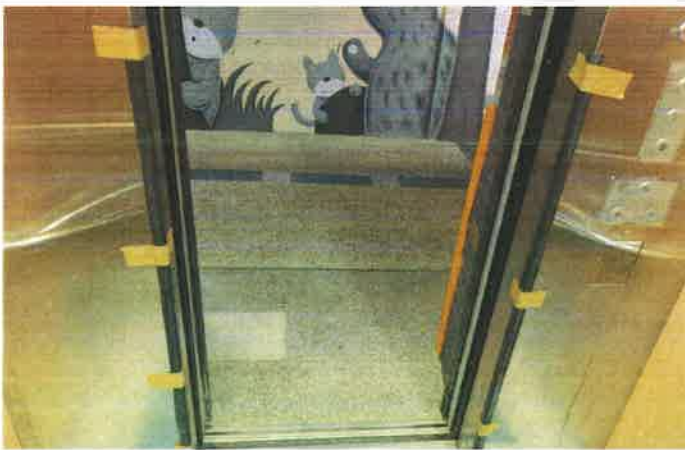
長安國小電梯已完成防撞條更新
